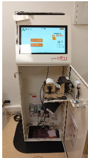
Kiosco Fujitsu - Con terminal Fujitsu Futro S520 reutilizado.
